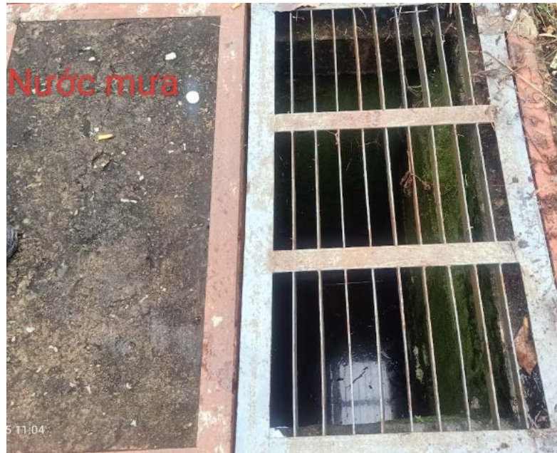
Hình 3.2. Hố ga đầu nối nước mưa KCN
